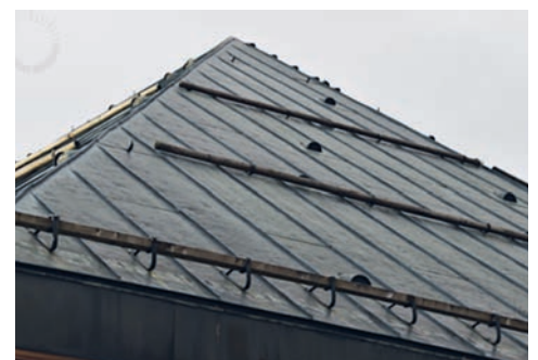
Abb 4: Durch Hagel getroffenes Kirchendach aus Kupfer-Stehfalzeindeckung
