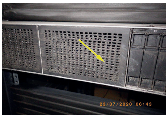
Abb.: Probe im Außenbereich eines „VMware Host“ entnommen, Ort der Probenahme mit Pfeil markiert.
