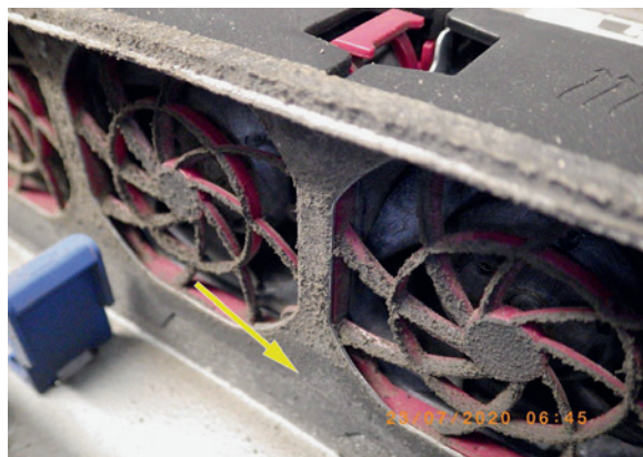
Abb.: Probe im Innenbereich eines „VMware Host“ entnommen, Ort der Probenahme mit Pfeil markiert.
