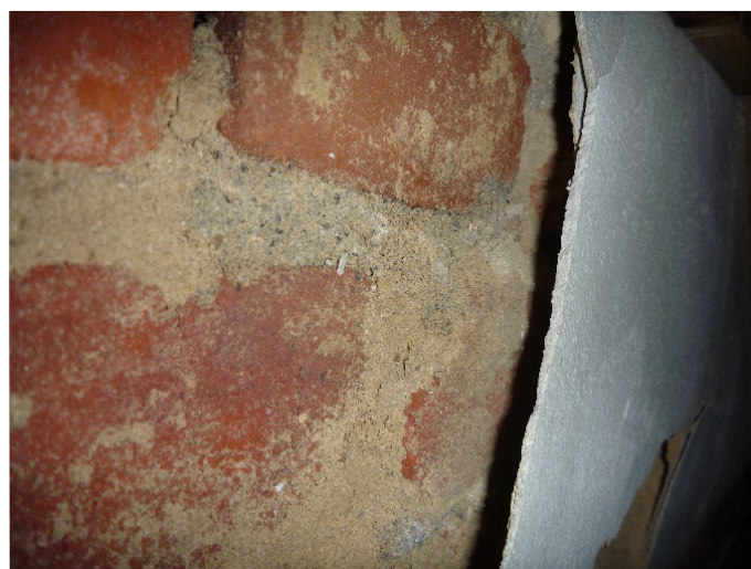
Bild 2: Aufgelöster Putz, lediglich Mauerwerk und Feinputzschicht vorhanden
