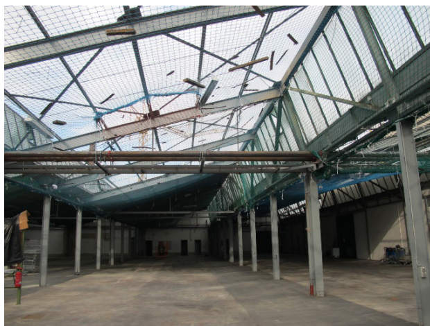
Bild 3: Halle mit Magnesia-Estrich nach Hagelschaden
