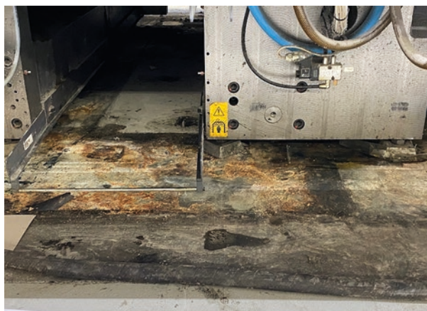
Bild 2: Extreme Verschmutzungen mit Korrosionsprodukten unterhalb der Druckwerke
